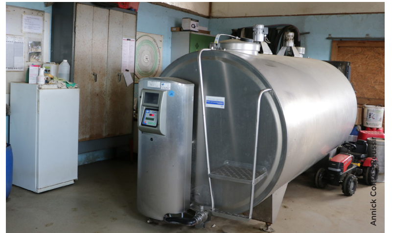
▲ Le tank à lait est le premier poste de consommation d'électricité du bloc traite.
